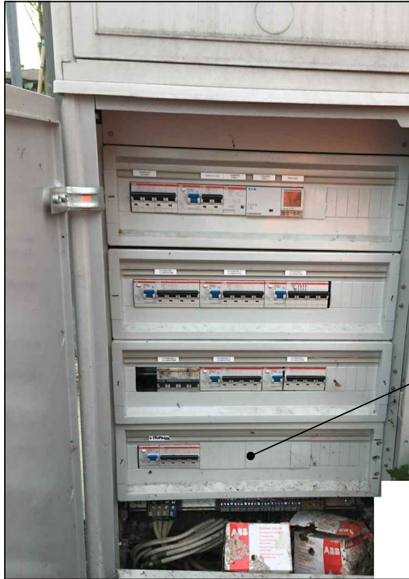
VISTA FRONTALE ARMADIO STRADALE QUADRO ELETTRICO GENERALE ESISTENTE POS. VIA XXV APRILE
